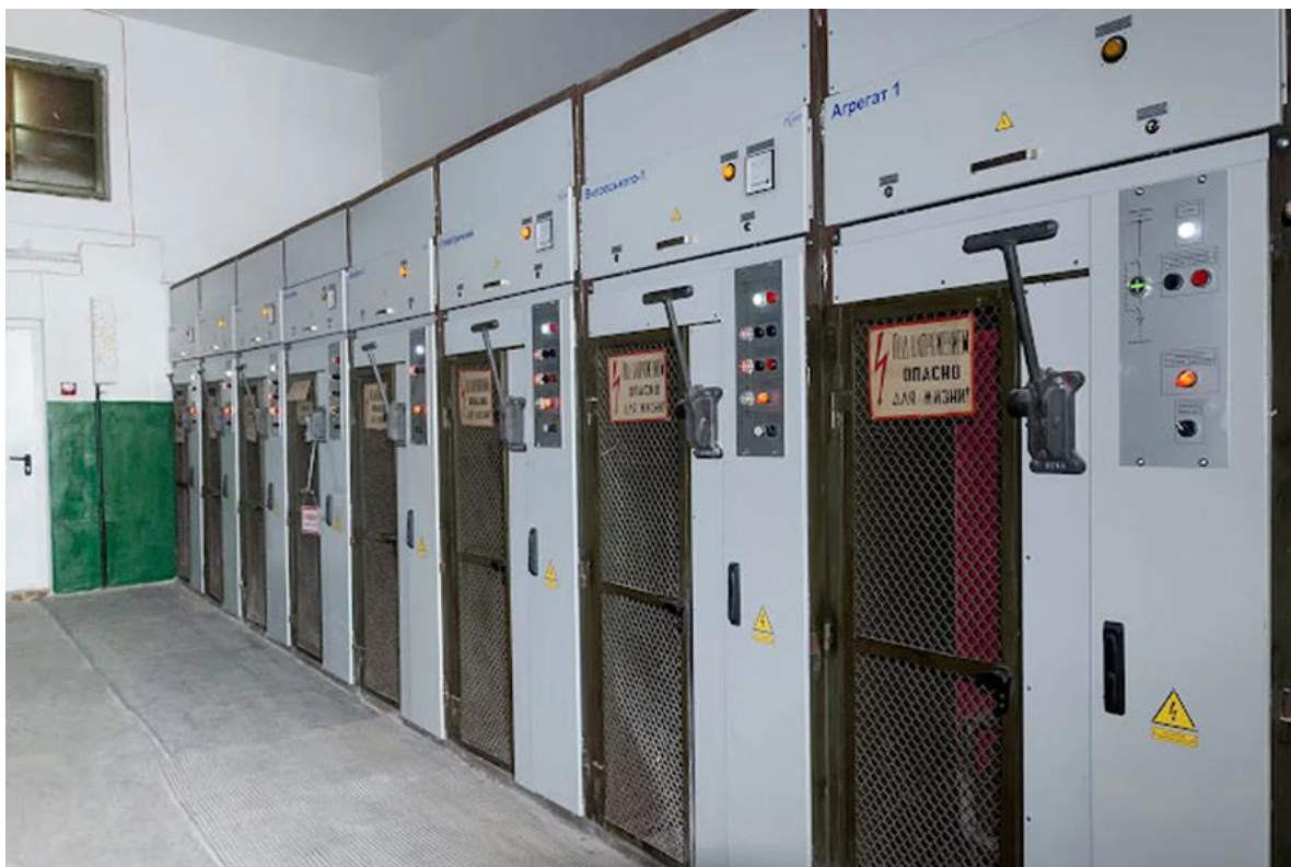
Рисунок 1 – Тягова підстанція РУ-825 СТП-49 київського метрополітену
