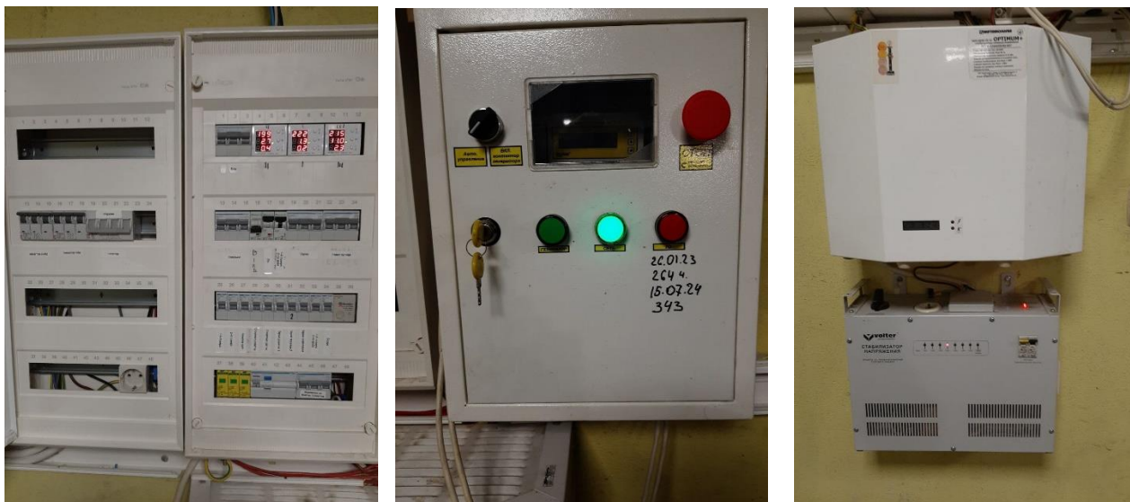
Рисунок 4 – Розподільчий щит із захисними автоматичними вимикачами, автоматичний пристрій включення малої електростанції 4 кВт і стабілізатор напруги
