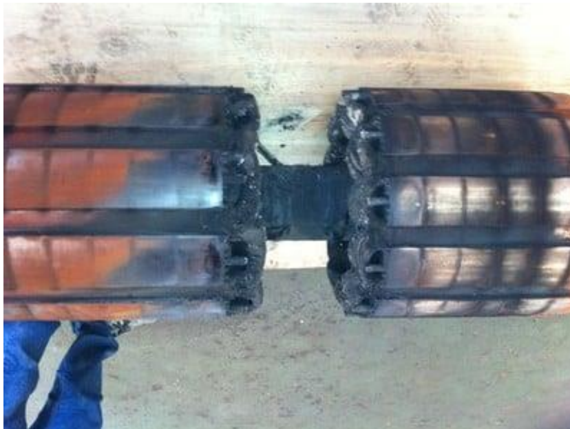
Рисунок 2 – Ротор з пошкодженою ізоляцією [2]
