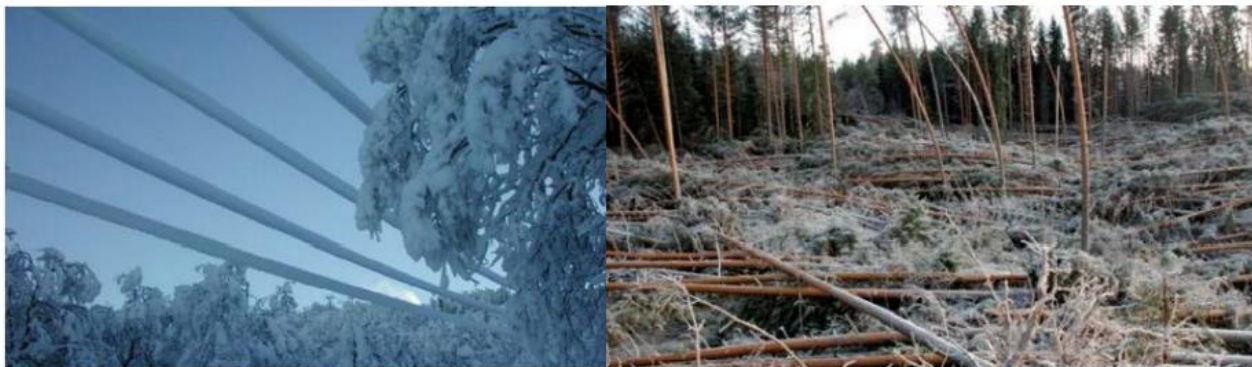
Рисунок 3 – Снігове навантаження на лінії електропередавання і пошкодження вітром
