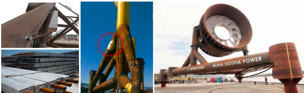
Рисунок 4 – Наслідки корозії складових металічних конструкцій
