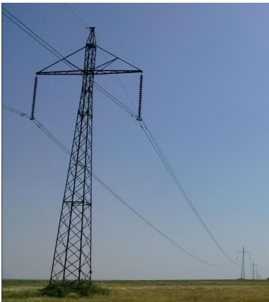
Рисунок 1 – Вигляд на опори біполярної лінії Волгоград-Донбас
