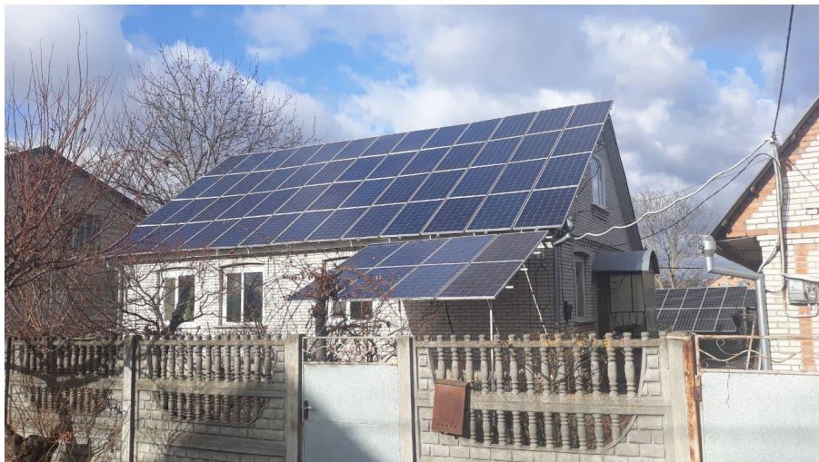
Рисунок 1 – Домогосподарство з встановленою сонячною електростанцією потужністю 16,2 кВт
