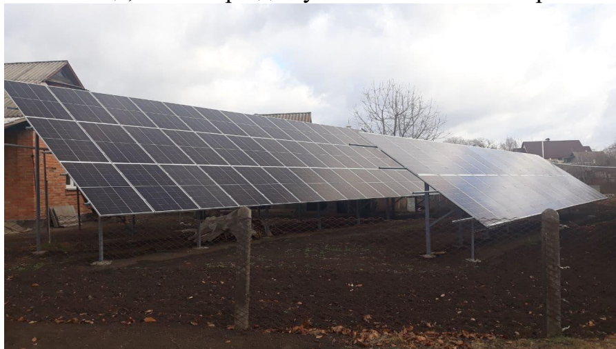
Рисунок 2 – Сонячна електрична станція потужністю 34,2 кВт в приватному домогосподарстві
