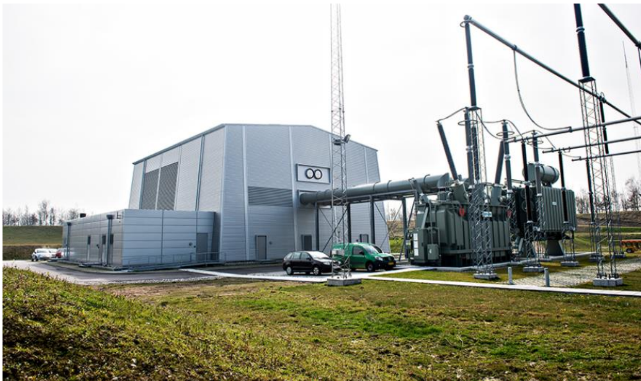
Рисунок 1 – Вигляд на місце установки синхронного компенсатора для Energinet.dk
