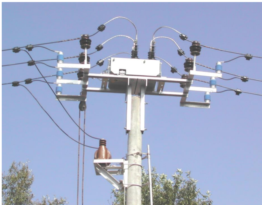
Рисунок 1 – Приклад встановлення реклоузера на опорі ПЛ
