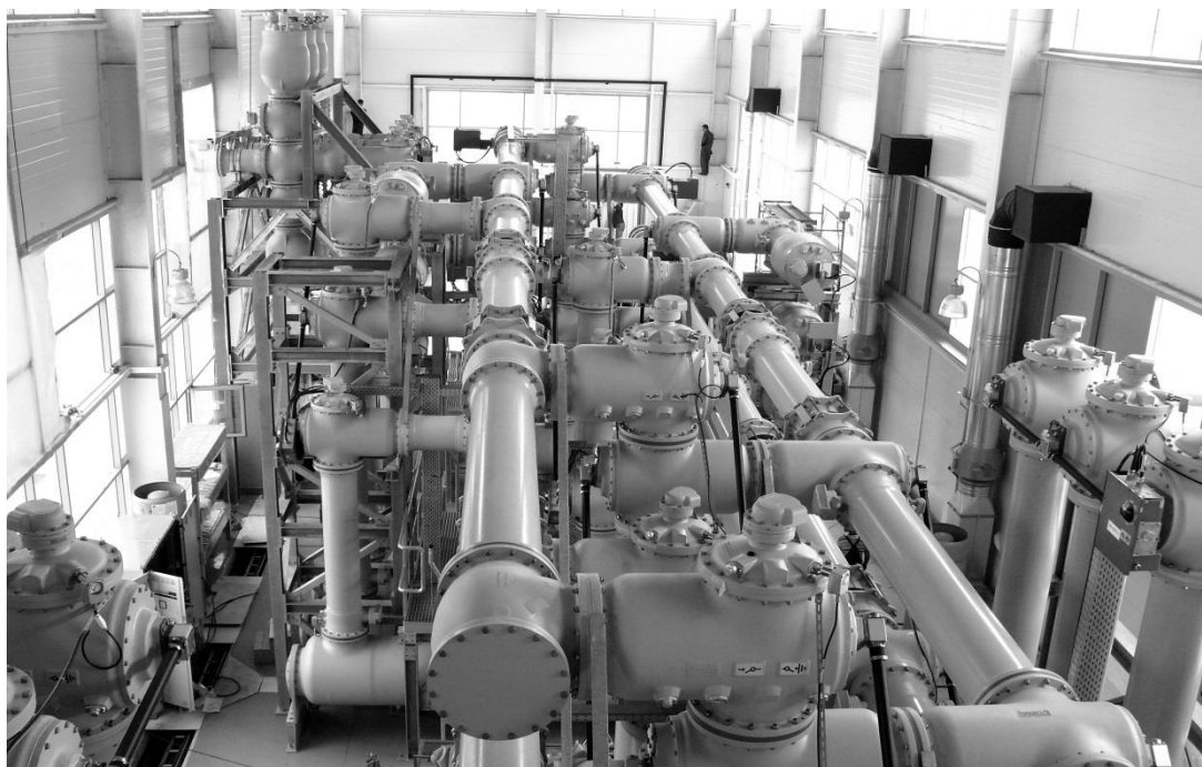
Рисунок 1 – Загальний вигляд першої черги КРПЕ 330 кВ Дністровської ГАЕС
