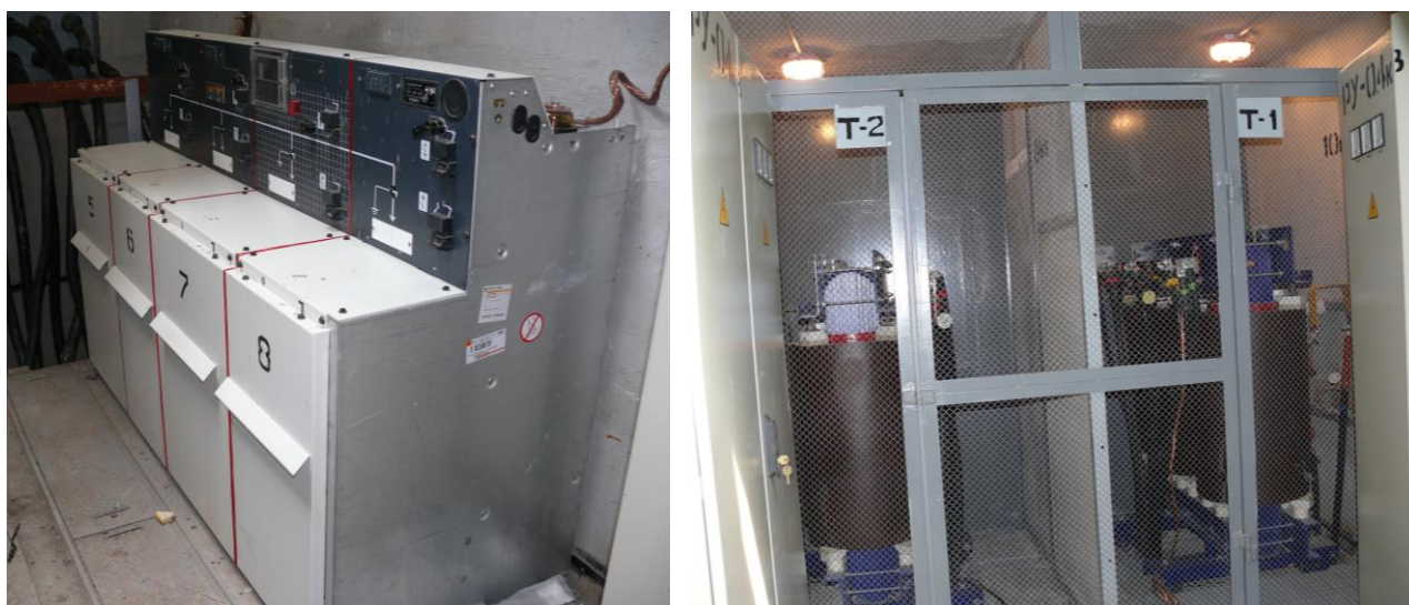
Рисунок 4 – Зовнішній вигляд встановлених шаф 0,4 кВ та силових трансформаторів
