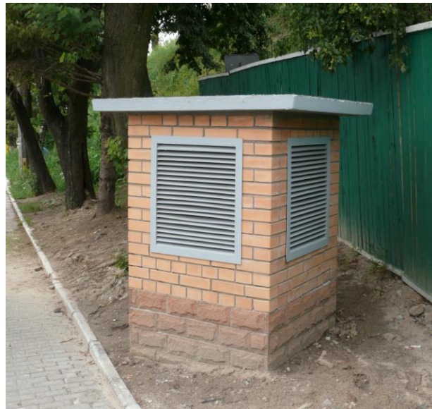
Рисунок 6 – Зовнішній вигляд вентиляційної системи
