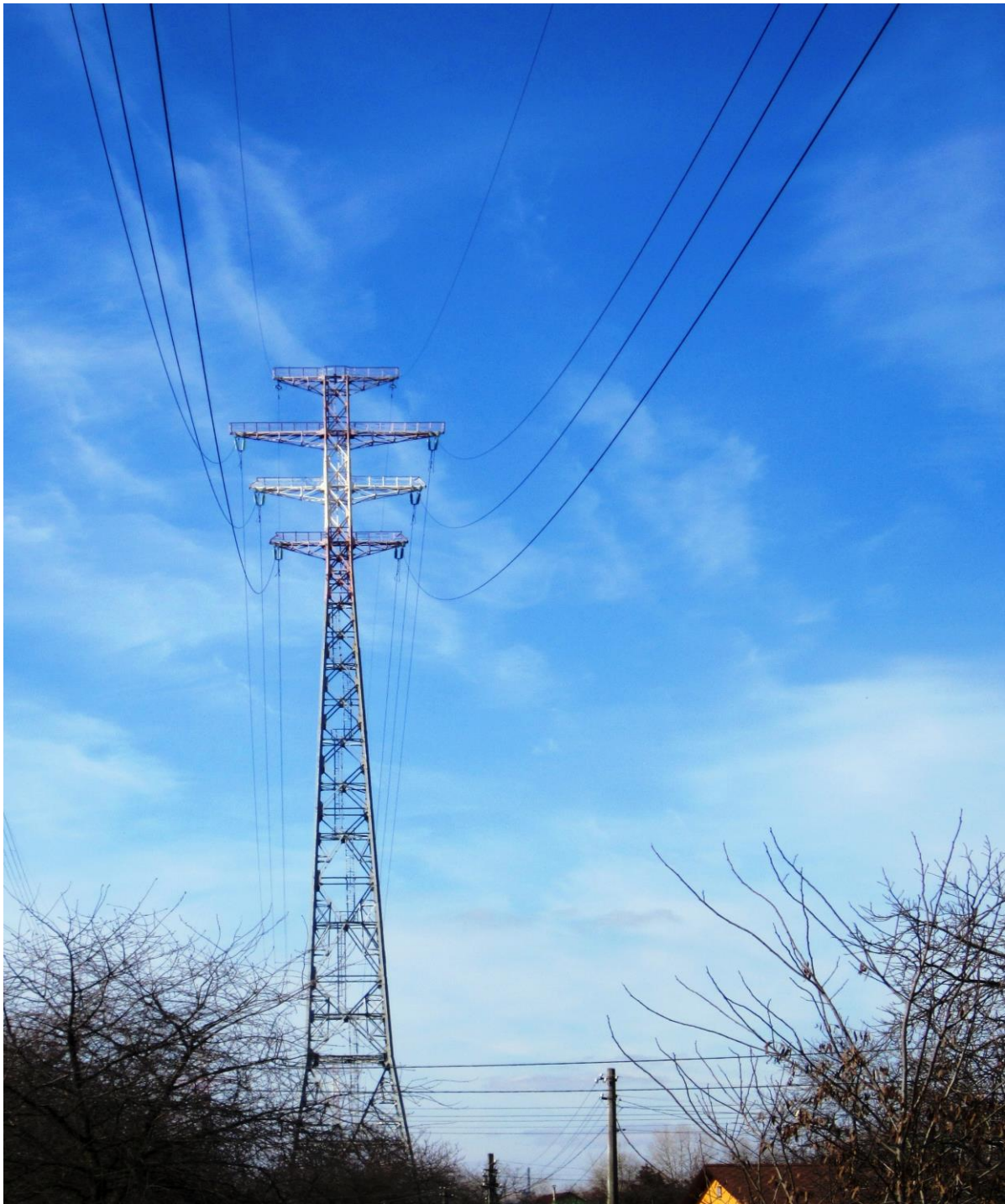
Рисунок 3 – Загальний вигляд перехідної опори № 46
